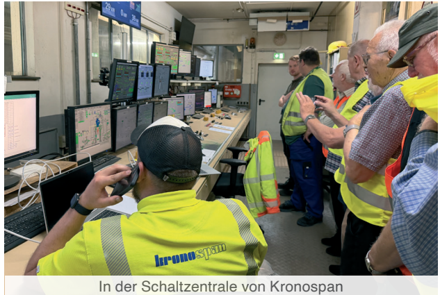
In der Schaltzentrale von Kronospan
